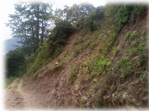
Figura 27. Apertura de carretera en la Localidad Buena vista dejando como consecuencia derrumbes en esta zona.
