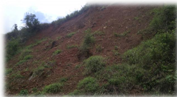
Figura 17. Derrumbe San José de Las Moras.
