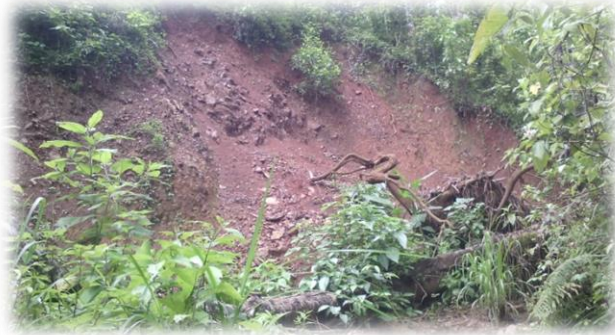
Figura 13. Vista general del derrumbe.
