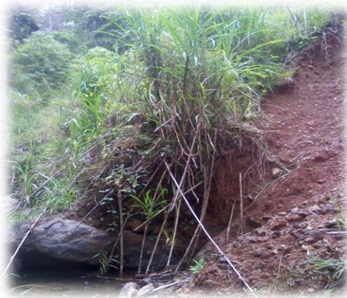
Figura 3. Rocas obstruyendo el curso de la Quebrada.
