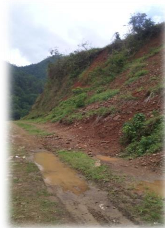
Figura 16. Lado izquierdo del deslizamiento.
